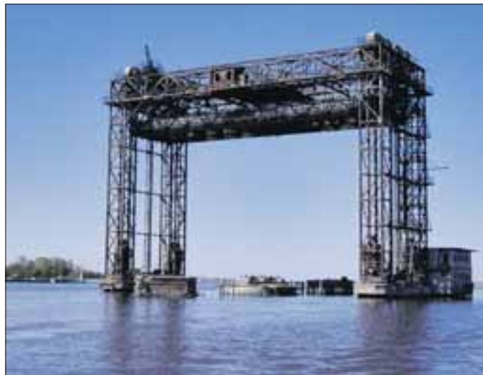
Die Reste der Karniner Brücke vor der Insel Usedom
